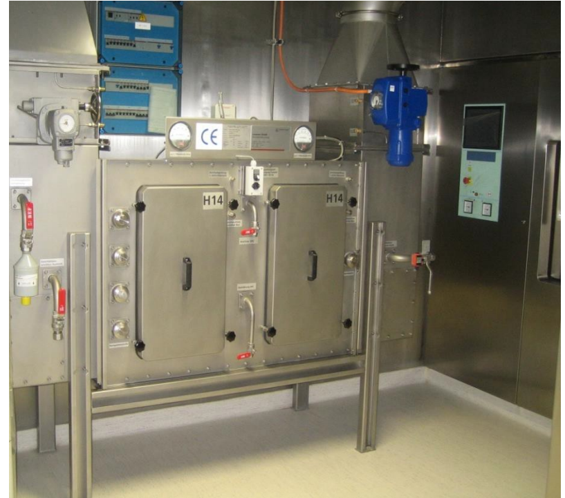
高效过滤器系统-主实验室
