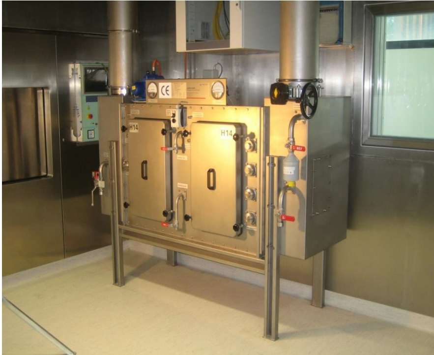
高效过滤器系统-置换实验室
